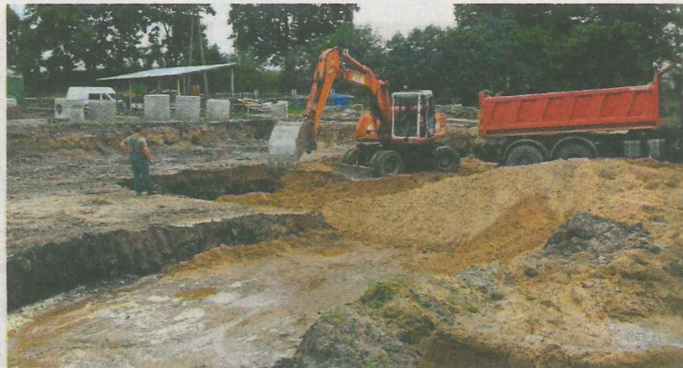
► Wykopy pod fundamenty Zakładu Aktywności Zawodowej w Juchowie. Cały obiekt ma być gotowy w lecie przyszłego roku
